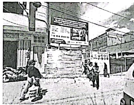
En un terreno del jr. Ayacucho se hará el local de Archivo
